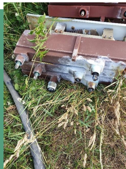
Skadet komponent – Høyohmige jordfeil
