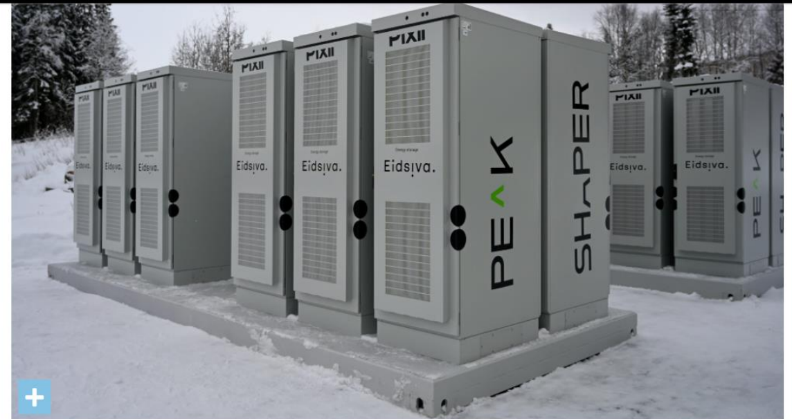
Batteriet som skal øke kapasiteten i distribusjonsnettet i Lierne. Foto: Eidsiva Energi
