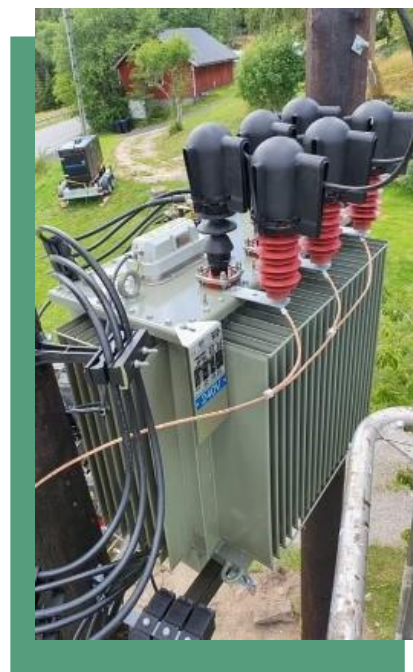
Fra Elvia sin demonstrasjon av automatisk spenningsregulerende fordelingstransformatorer.
