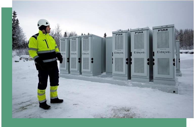
Et batterisystem ble installert i Tensio sitt distribusjonsnett i Lierne kommune i desember i 2022 som en del av et pilotprosjekt i IDE-prosjektet (Foto: Tensio)
