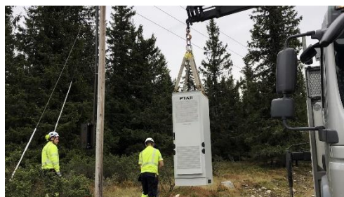
Figur 3: Montasje av Pixii-batterier i lavspent fordelingsnett hos Elvia.
